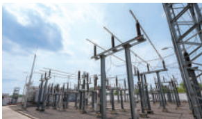
TRẠM BIẾN ÁP ĐIỆN AMATA 110KV
