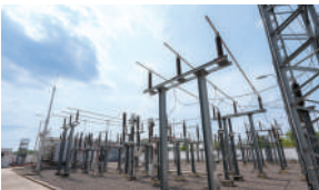
아마타 110kV 변전소
